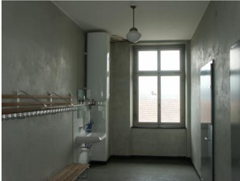
Sanierungsbedürftiger Korridorbereich im Primarschulhaus
