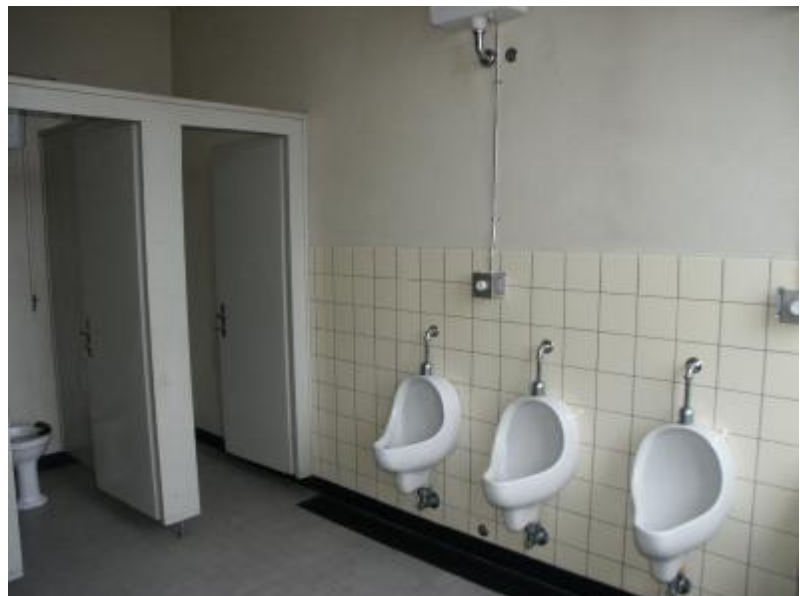
Sanierungsbedürftige WC-Anlage im Primarschulhaus
